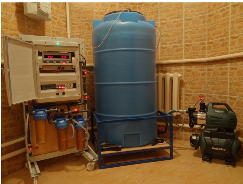
Рис. 7. Установка ИЗУМРУД-УНИВЕРСАЛ-500 в качестве основного универсального устройства очистки и кондиционирования воды в коттедже. При срабатывании датчика нижнего уровня очищенной воды в накопительной емкости вода из скважины с постоянным расходом 500 литров в час поступает в накопительную емкость, предварительно пройдя все стадии очистки в установке ИЗУМРУД-УНИВЕРСАЛ-500. При достижении верхнего уровня в накопительной емкости установка ИЗУМРУД-УНИВЕРСАЛ отключается. Станция повышения давления, соединенная с накопительной емкостью и подключенная к внутримдомовой системе водоразведения, обеспечивает чистой водой весь коттедж в любое время и в любом требуемом количестве.
